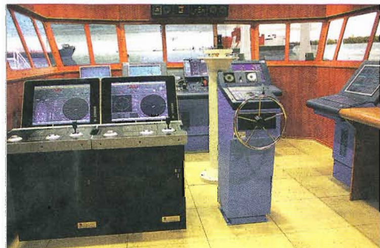
Mostek z konsolami DP w Akademii Morskiej w Szczecinie.
